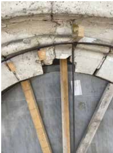
Étaie et calage des clavaux de la rose en cours de restauration
