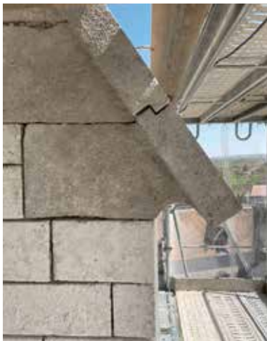
Dégradation des joints d'un contrefort et nettoyage du parement
